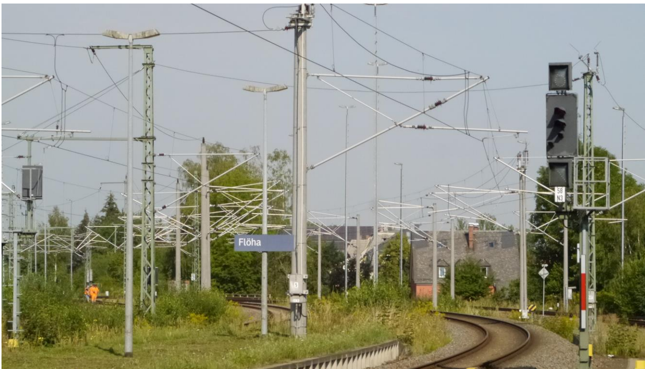
elektrifizierte Strecke Chemnitz-Dresden Blick nach Chemnitz Bild von 2020
